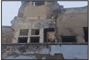
■ मदारगेट पुलिस चौकी के पीछे जर्जर मकान की छत गिरने से दो मजदूर दब गए।
